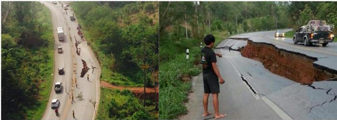
รูปที่ 10-2 รอยแตกบนถนน บริเวณที่หลักกิโลเมตร 151 –152 บนทางหลวงหมายเลข 118
