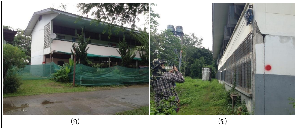
รูปที่ 4-1 สภาพอาคารเรียนที่ได้รับผลกระทบจากแผ่นดินไหวโรงเรียนชุมชนบ้านป่าก่อดำ (ก) ลักษณะด้านหน้าอาคาร และ (ข) ด้านหลังอาคารเรียน
