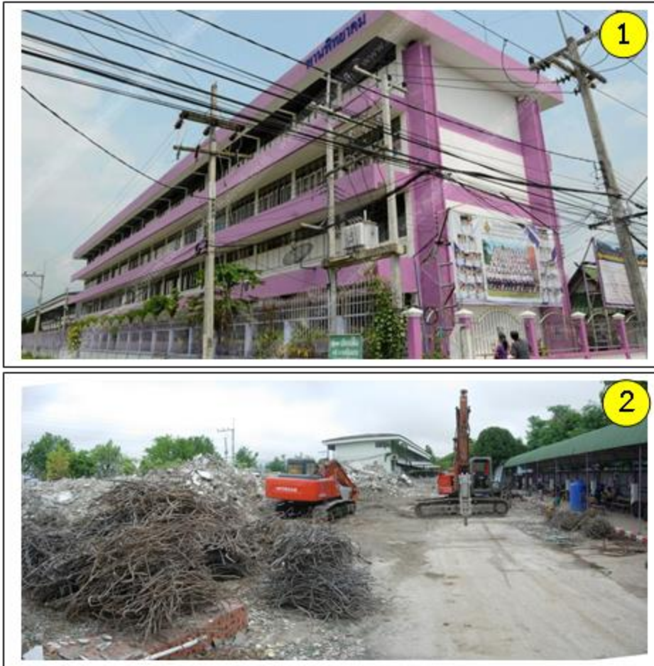
รูปที่ 12-1 โรงเรียนพานพิทยาคมและอาคาร 4 ที่ต้องรื้อถอน (1) และกำลังรื้อถอน (2) (ภาพถ่ายเมื่อ 20 กค. 57)
