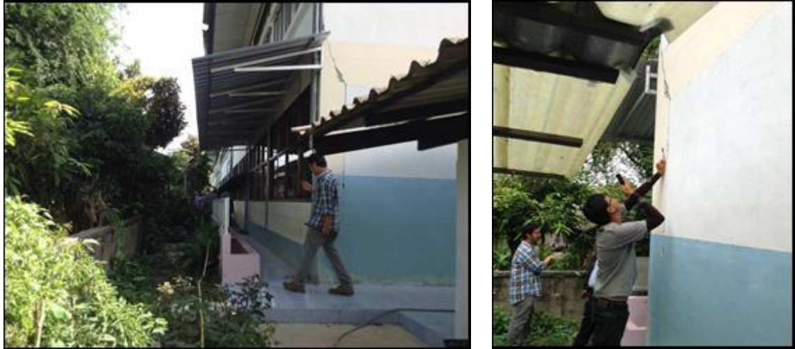
รูปที่ 22-2 ความเสียหายที่พบบริเวณอาคารเรียน โรงเรียนอนุบาลเชียงราย
