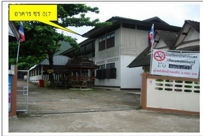
รูปที่ 17-1 อาคารชร017 ต้องรื้อถอน (ภาพถ่ายเมื่อ 23 กค. 57)
