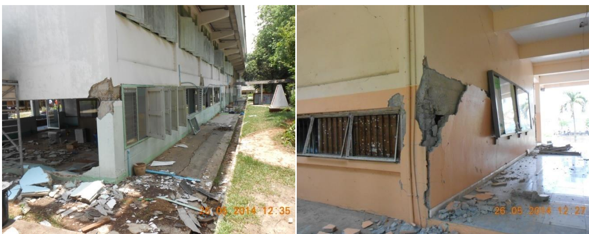
รูปที่ 1-2 ความเสียหายของอาคารเรียน โรงเรียนแม่ลาววิทยาคม
