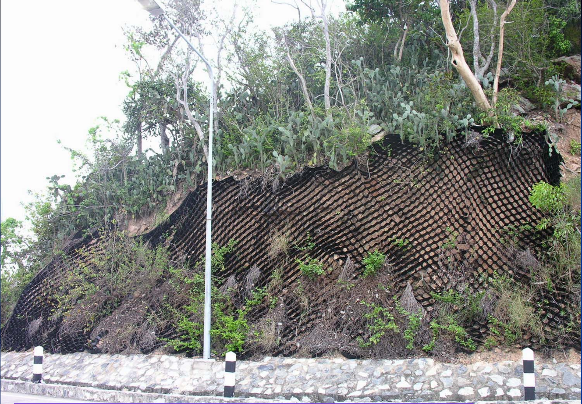
ตาข่ายเหล็กป้องกันดินถล่มบริเวณหัวเขาพระบาททัพพระยาต้านเหนือ อำเภอบางละมุง
