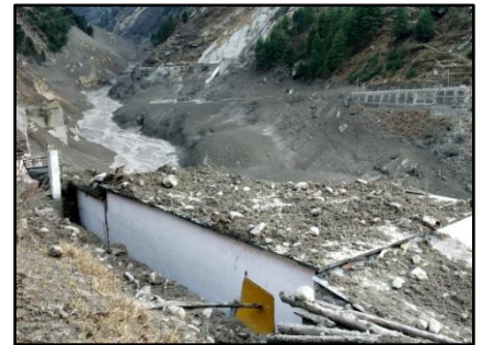
ภาพความเสียหายของเขื่อนหลังจากเหตุการณ์ธารน้ำแข็งถล่ม (ที่มา : Independent)
