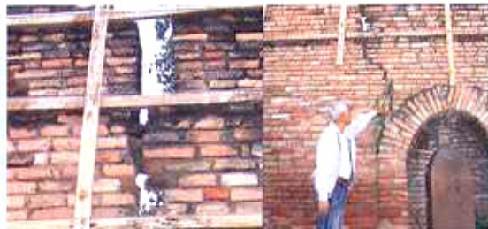
ประตูเมืองเชียงใหม่ มีรอยร้าวมากขึ้น หลังเหตุการณ์ แผ่นดินไหว
