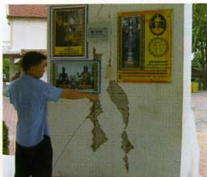
อนุสรณ์ฯ สมเด็จพระนเรศวรมหาราช อ.แม่สาย จ.เชียงราย ผนังด้านใน พบคอนกรีตที่ฉาบมีการหลุดกระเทาะ ลงมาและผนังมีรอยร้าว
