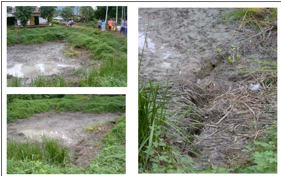
รูปที่ 4-4 หลุมยุบบริเวณบ่อน้ำในหมู่บ้านเขาหลัก ตำบลน้ำผุด อำเภอห้วยยอด จังหวัดตรัง
