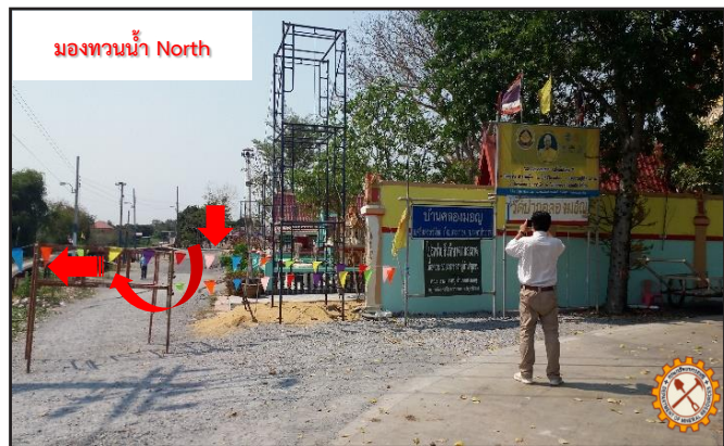
รูปแสดงการปรับพื้นที่ทรุดตัวของถนนหน้าวัดติดจุดเกิดเหตุ
