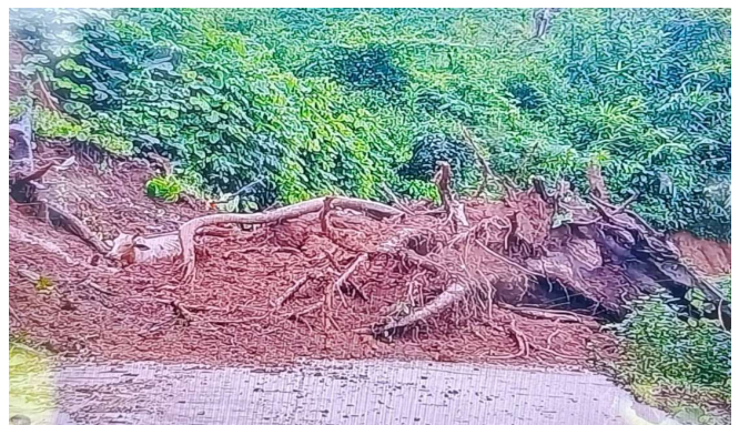
แผ่นดินถล่มบริเวณเส้นทางเข้าหมู่บ้านกอมูเดอ ตำบลแม่สามแลบ อำเภอสบเมย จังหวัดแม่ฮ่องสอน
