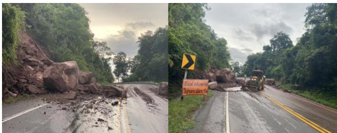
ภาพความเสียหายจากแผ่นดินถล่มบริเวณทางหลวงหมายเลข 12 ตอนน้ำคอก-ห้วยข่ามะควากิโลเมตรที่ 379+800 ตำบลน้ำพุ อำเภอชนแดน จังหวัดเพชรบูรณ์ (ที่มา : เพจหมวดทางหลวงน้ำหนาว)
