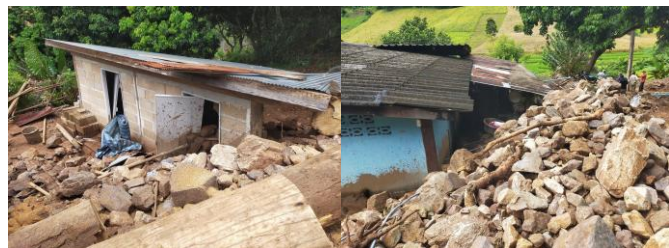
ภาพความเสียหายในพื้นที่จากเหตุการณ์แผ่นดินถล่มในพื้นที่ตำบลแม่ลาน้อย อำเภอแม่ลาน้อย
