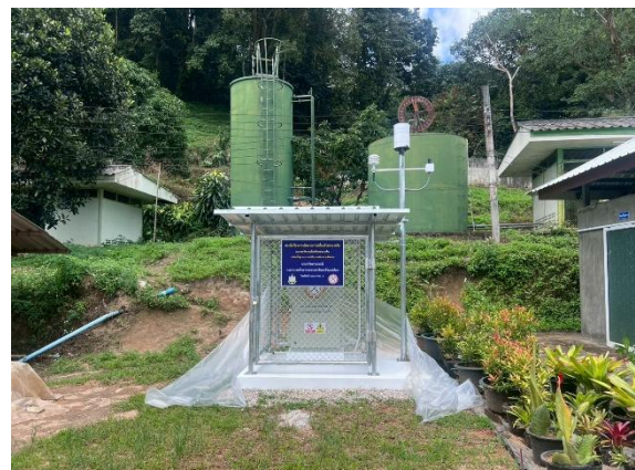
ติดตั้งเครื่องตรวจติดตามการเคลื่อนตัวของมวลดิน พื้นที่บ้านห้วยน้ำซุ่น ตำบลท่าก้อ อำเภอแม่สรวย จังหวัดเชียงราย
