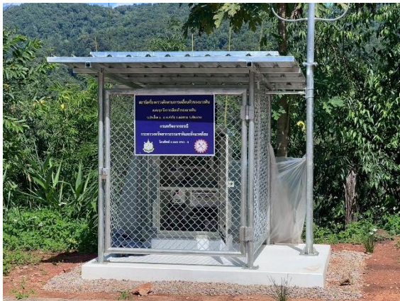
ติดตั้งเครื่องตรวจติดตามการเคลื่อนตัวของมวลดิน พื้นที่บ้านป่าเกี๊ยะ ตำบลท่าก้อ อำเภอแม่สรวย จังหวัดเชียงราย
