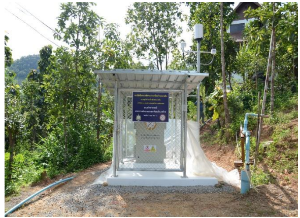
ติดตั้งเครื่องตรวจติดตามการเคลื่อนตัวของมวลดิน พื้นที่บ้านห้วยไผ่ ตำบลแม่มะยม อำเภอสะเรียง จังหวัดแม่ฮ่องสอน
