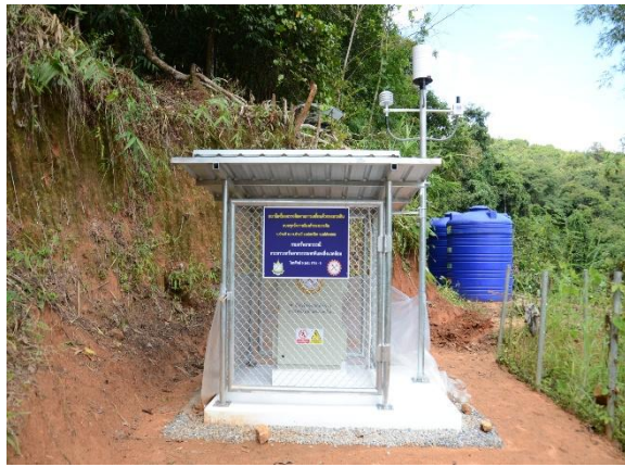
ติดตั้งเครื่องตรวจติดตามการเคลื่อนตัวของมวลดิน พื้นที่บ้านป่าแป๋ ตำบลสะเรียง อำเภอสะเรียง จังหวัดแม่ฮ่องสอน
